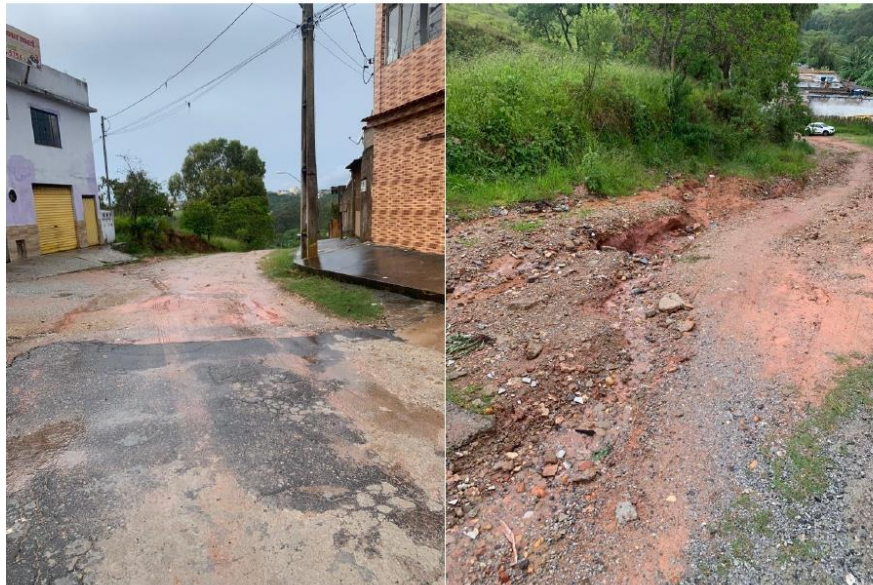
Figura 4 - Atual situação do trecho a ser pavimentado
